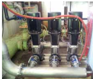
↑ Automatická tlaková stanice.
