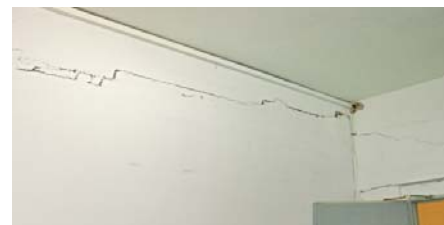
Poškozená chodba k restauraci Harmonie.
