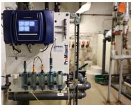
Automatické dávkování chemických látek pro udržení stálé kvality bazénových vod. Je zde vidět vyhodnocovací řídicí jednotka s měřicími sondami, v pozadí dávkovací čerpadla chemie, která dostávají povel od řídicí jednotky
